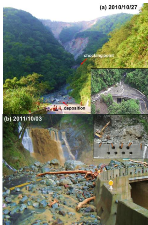
圖 6 台 9 線 115.9K 大坑橋土砂堵塞 (a) 梅姬颱風後; (b) 奈格颱風後 (photos : Directorate General of Highways, M.O.T.C.)
