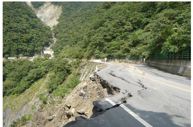
圖 9 台 9 線 115.8K 路面垂直裂隙 (date: 2011/10/27) Fig.9 Vertical crack along the roadway at 115.8K of Route 9
