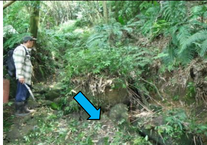
10. 右側支流上游側, 左側河道有落石崩落(308630,2768388)
