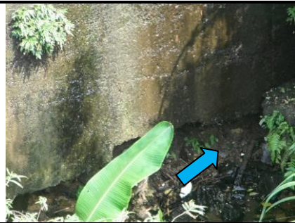
8. 右側支流護岸基礎淘刷(308544, 2768448)
