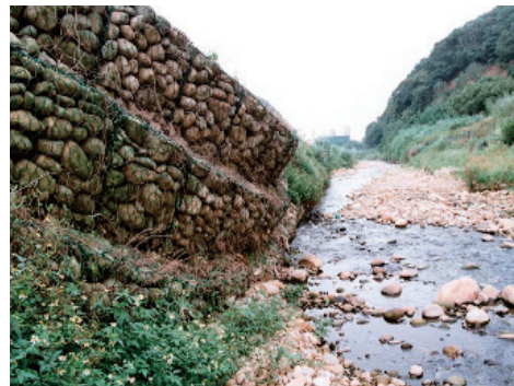
(d) 箱籠擋土護岸破壞案例 4 (廖根遠2006) (d) Roll gabion revetment failure case No.4
